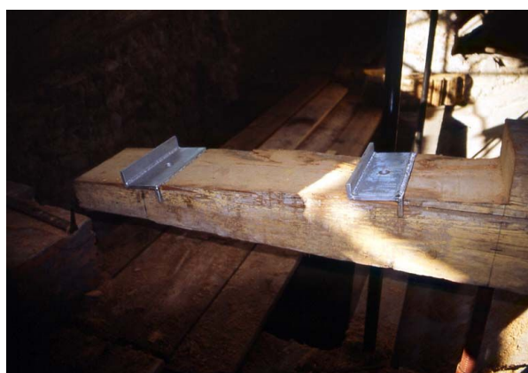
Vista della catena già conformata
