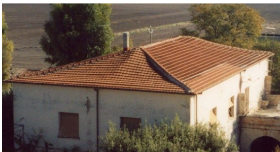
Deformazioni di una copertura in legno.
