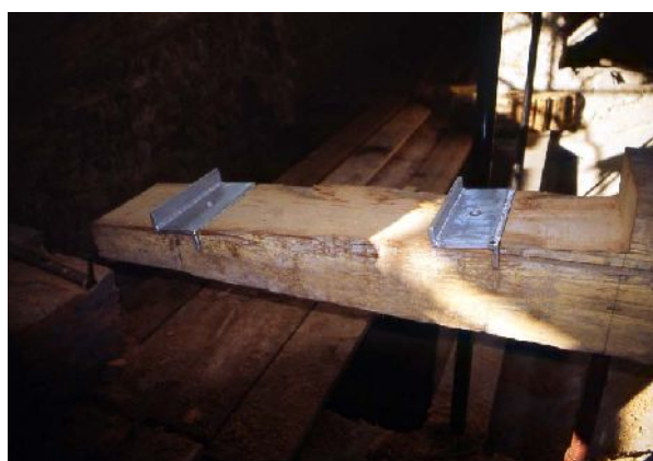
Vista della catena già conformata
