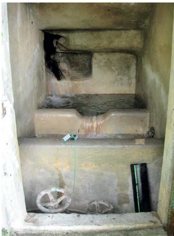
Fig. 35 – Sostituzione dei fluocaptori all'interno dell'opera di presa della Sorgente Trota (foto R. Zorzin)
