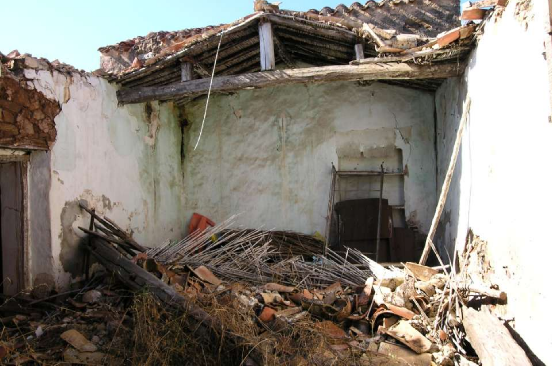
Gli interni. Le conseguenze dell'incendio.
