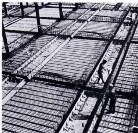
Le casseforme per il getto in opera dei solai / Molds for in situ floor casting
