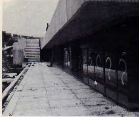
Elemento finestra esterna tipo, con i carter dei pilastri, prima della posa in opera della griglia metallica di protezione / Typical external window frame, with the carter of columns, before the steel grid erection
