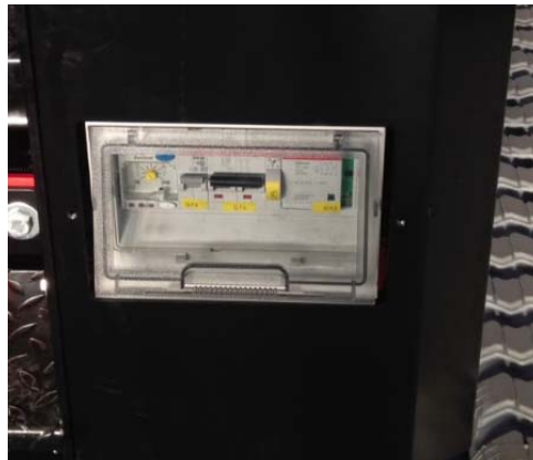
32. Quadro differenziali inverter (se presente)
