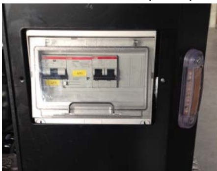
15. Quadro differenziali principale
