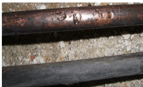
Tubo idraulico danneggiato
