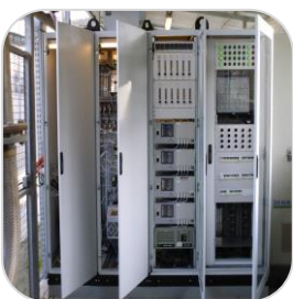
Sistema Quadricanale impianto cogenerazione
