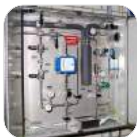
Sistema Condizionamento in cabinet chiuso e termostato
