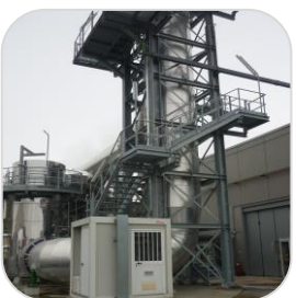
Sistema SME certificato in cabina area sicura
