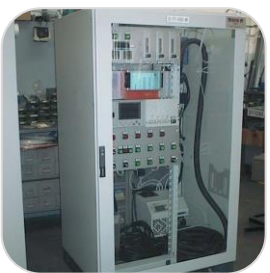
CEMS e linea riscaldata Gruppo Alstom Power
