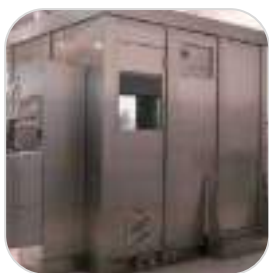
Shelter EEx p Raffineria Gruppo ENI
